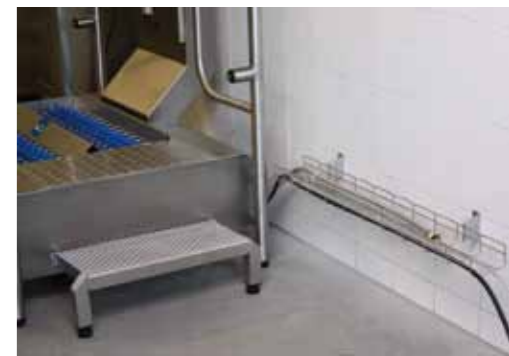
Hygiene steht im Lebensmittelbereich im Vordergrund. Cablofil-Komponenten bieten hier maximale Sicherheit. Alle Komponenten wurden auf eine Minimierung der Ablageflächen ausgelegt und sind besonders leicht zu reinigen. Nachbehandelte Edelstahloberflächen sorgen zudem für eine deutlich erhöhte Korrosionsfestigkeit.
