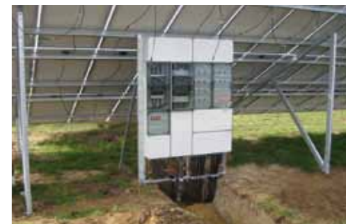
GTi-System: Schaltanlage für Photovoltaikanlagen.
